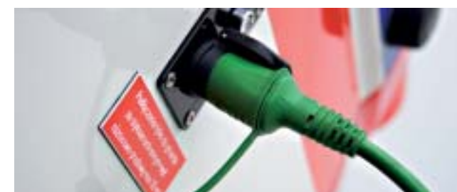
Przyłącze zewnętrzne instalacji 230V pozwala na ładowanie akumulatorów i zasilanie odbiorników w przedziale medycznym.
